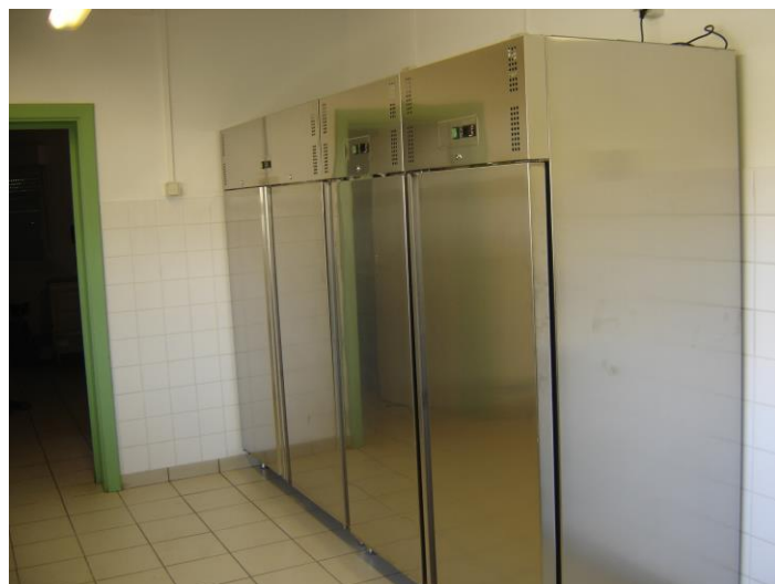
Les nouveaux réfrigérateurs et le congélateur
